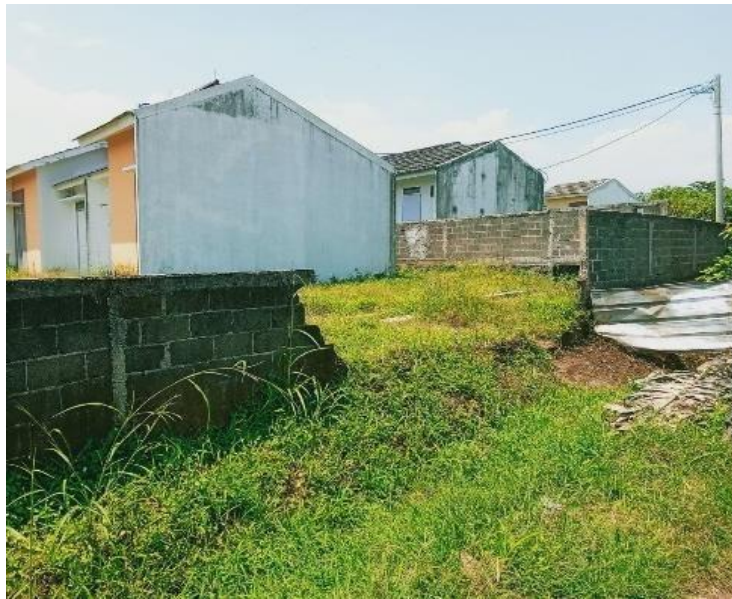
Gambar 3. Dinding pembatas yang rubuh
